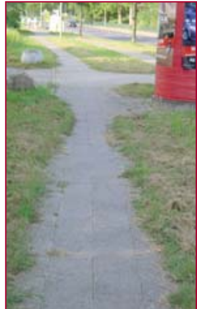
So sah der Gehweg auf dem Friedhofsgelände vor der Sanierung aus. Foto: Manfred Bisle
